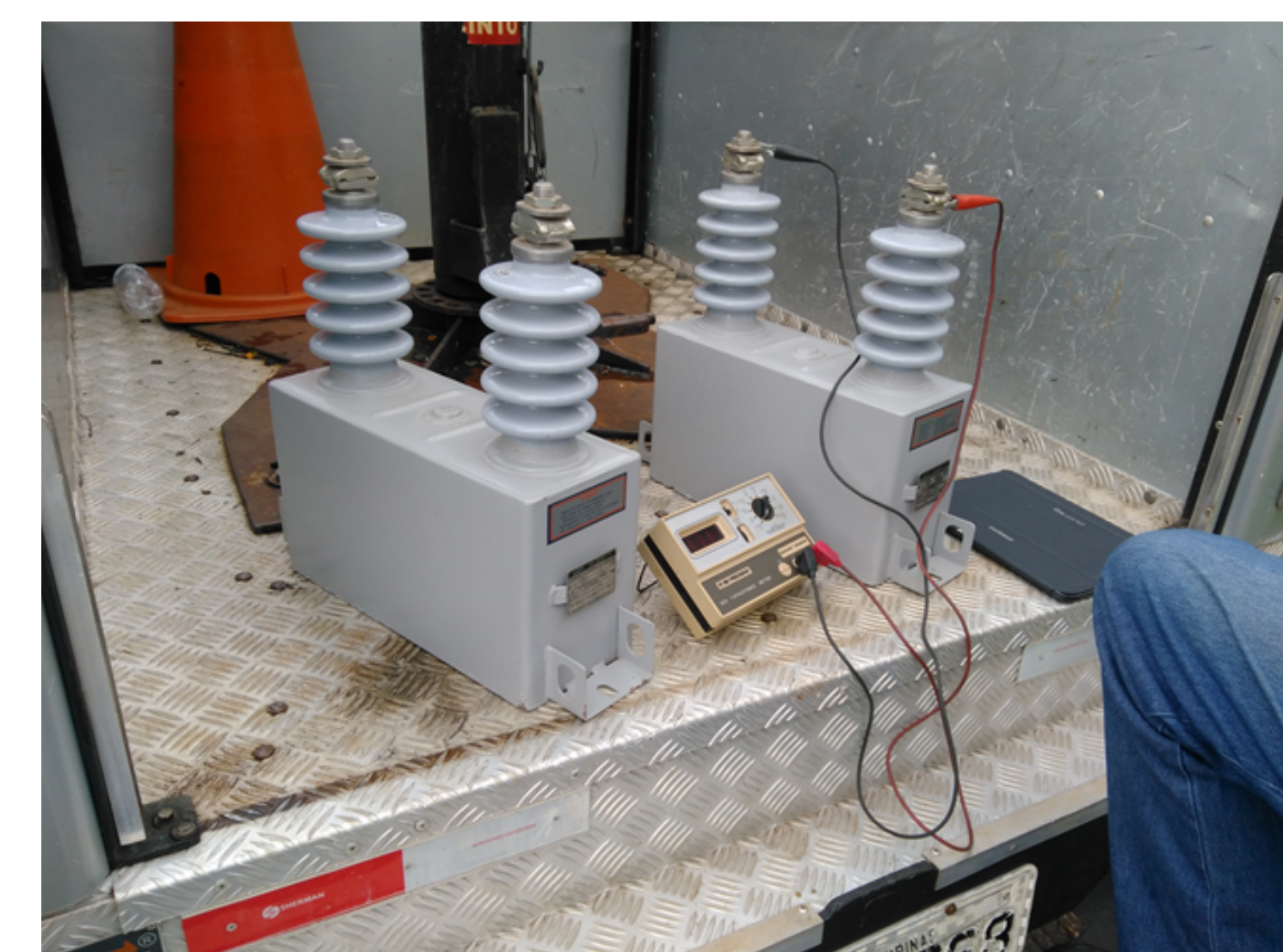
Imagem 2 - Ensaio de Células Capacitivas de Média Tensão.
