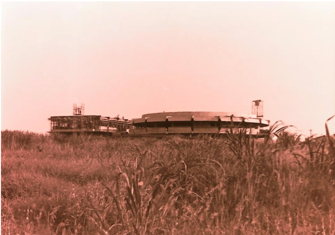
Fotografia 1 – Construção do prédio do Ciclo Básico da Unicamp em inícios da década de 1970 (Acervo pessoal de Peter Fry, data desconhecida).
