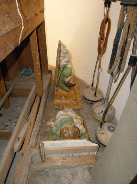
figura11.jpg - Peanhas removidas e colocadas diretamente sobre o chão, atrás do retábulo, com fiação elétrica aparente e enceradeiras ao lado. Fonte: Cristiana Cavaterra, maio/2014.
