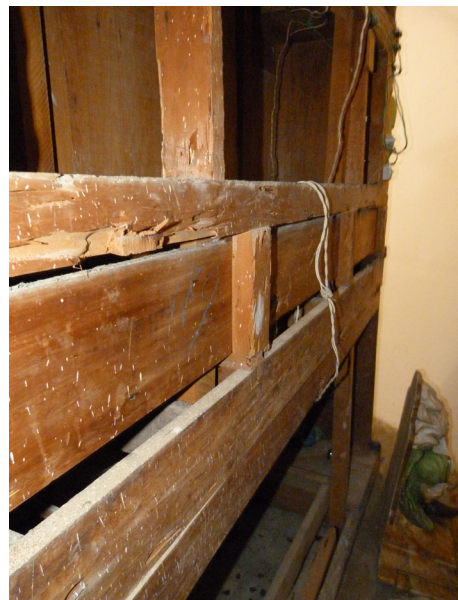
figura10.jpg - Detalhe do reverso do retábulo com ataque de xilófagos e fiação elétrica aparente. Fonte: Cristiana Cavaterra, maio/2014.
